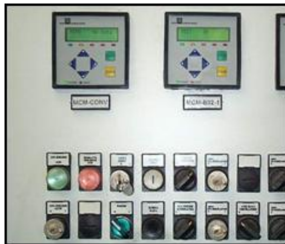
图 2. MCM 按照于 MCC 控制柜前面板
